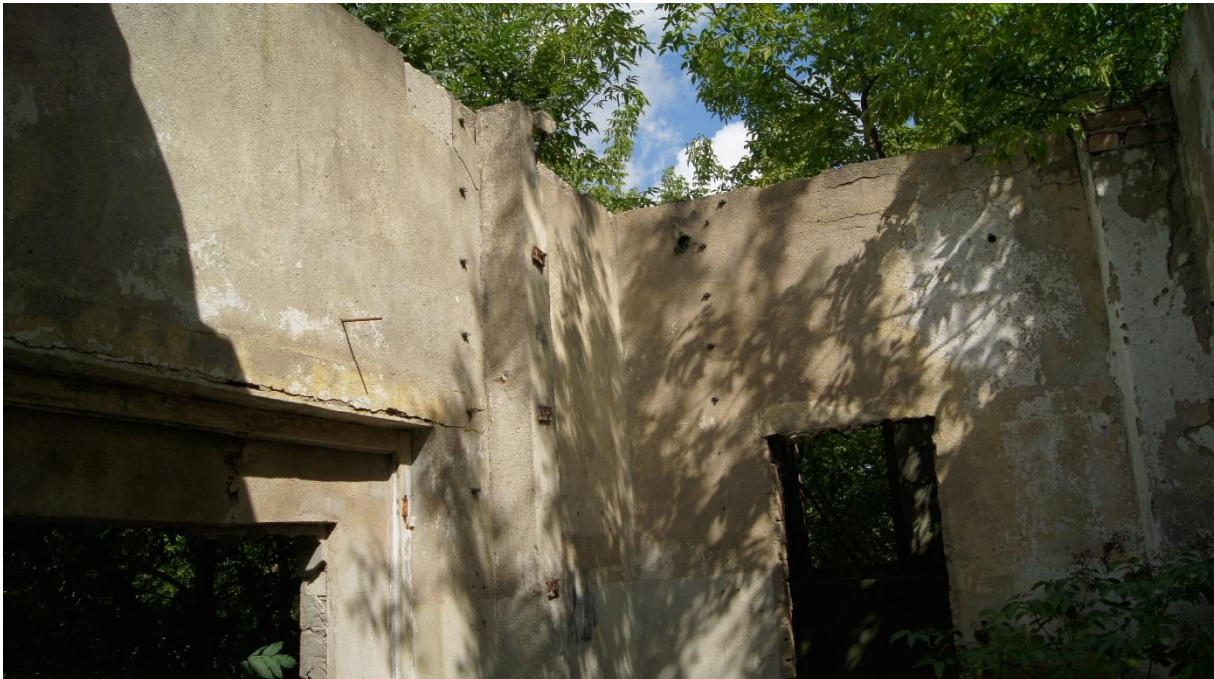
Abb. 7: verbliebene Wände der Stallruine ohne Dach
